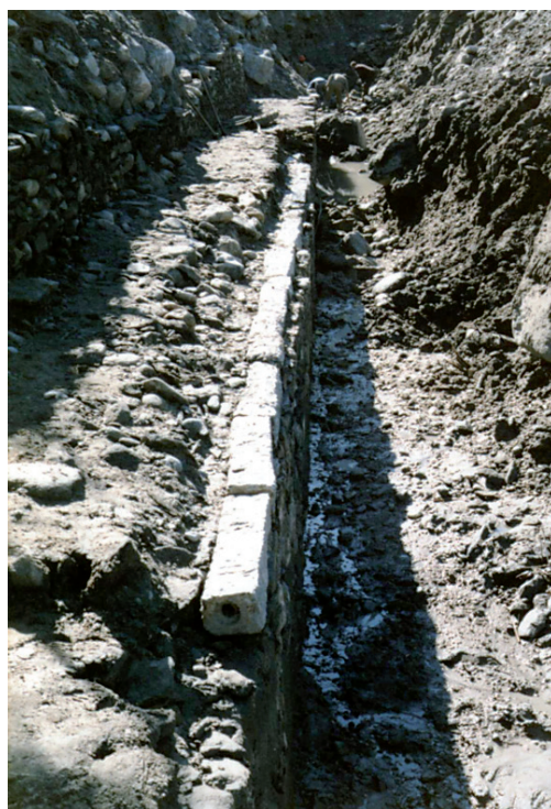
Figura 4a - 4b: Particolari del condotto semincassato nel terreno su muro di sostegno.
