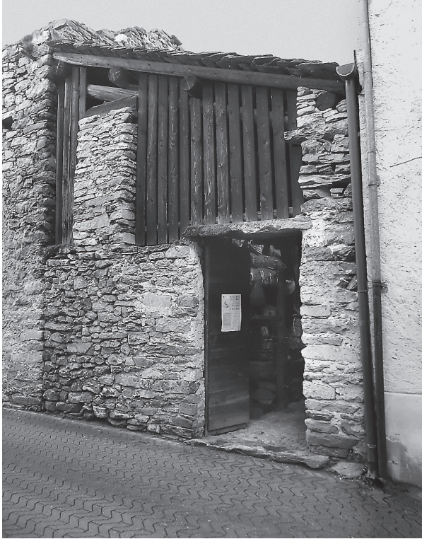
L'edificio che ospita il torchio a trave pressante a Santa Croce di Piuro.
